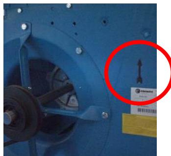
Figur 198: Rotasjonsmarkering av vifter i huset
