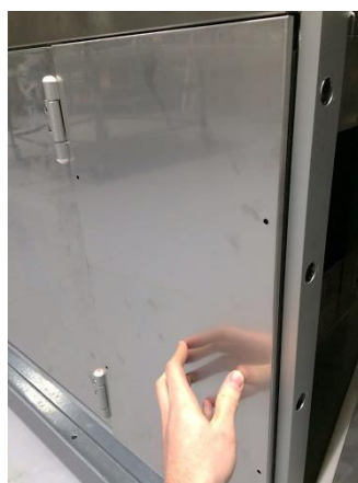
Figur 91: Det ytre panelet er ikke skrudd fast
