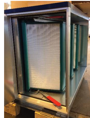
Figur 151: Filterseksjon med innsatte filtre
