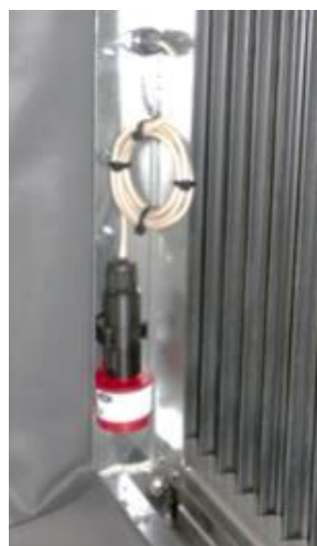
Рисунок 55: Монтированный детектор газа
