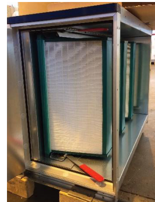
Resim 150: Filtrelerin takılmış hali
