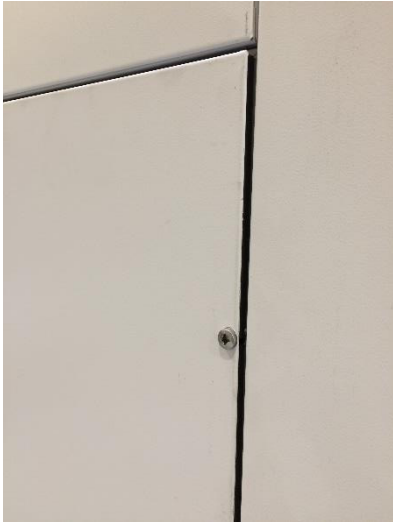
Resim 129: Sabit kapı paneli (TRA-E)
