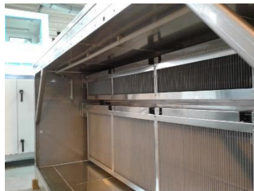
Resim 161: Filtre çerçevesindeki elektrostatik filtre
